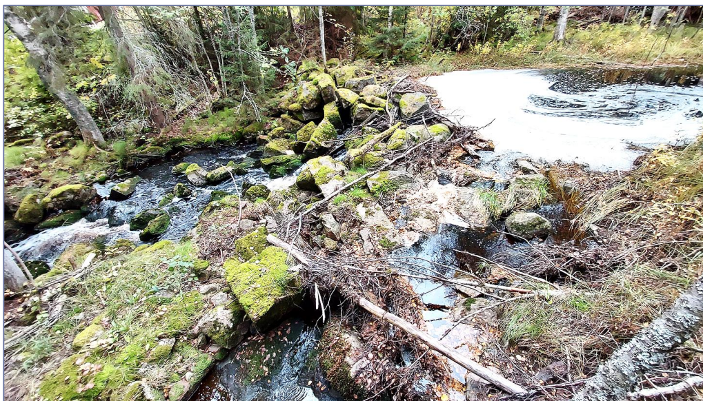
Kuva 5.5. Parkusojan alaosassa on ihmisen tekemä kivipato, joka tulisi muuttaa koneellisella kunnostuksella kalojen kuljettavaksi. Pato on totaalinen nousueste kaikilla virtaamilla.
